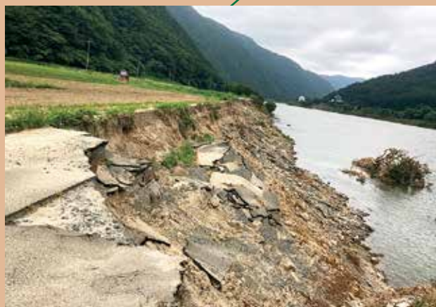
草薙頭首工管理道路の洗掘状況
